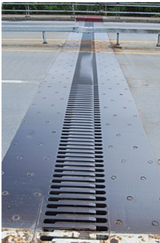
Сл. 89. Дилатација на пешачки мост
